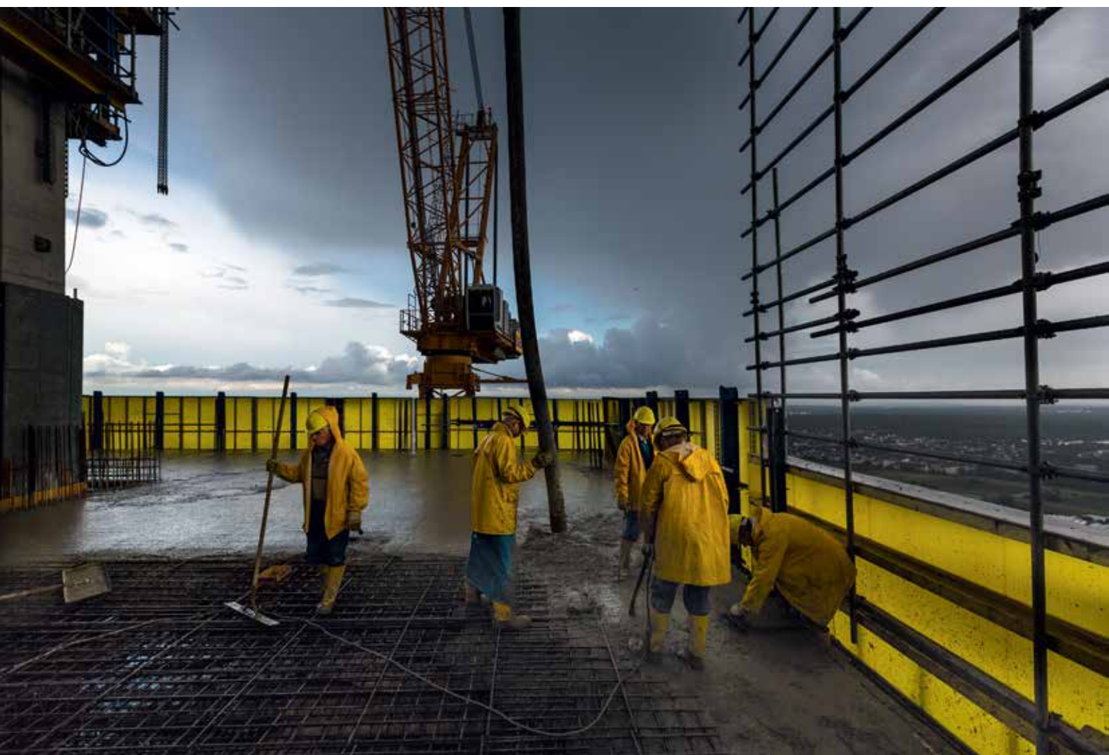
Efter at byggearbejdet på højhusets etageadskillelser er færdiggjort, er ECB et skridt nærmere mod at flytte til det nye kvarter: Ostend.
